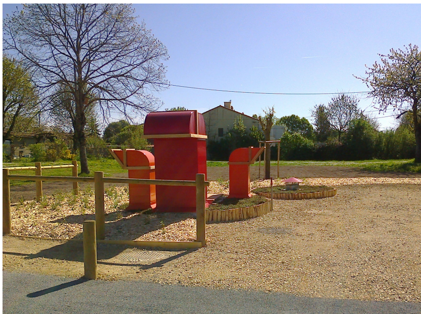
Figure 2 : poste Refoulement Amuré
