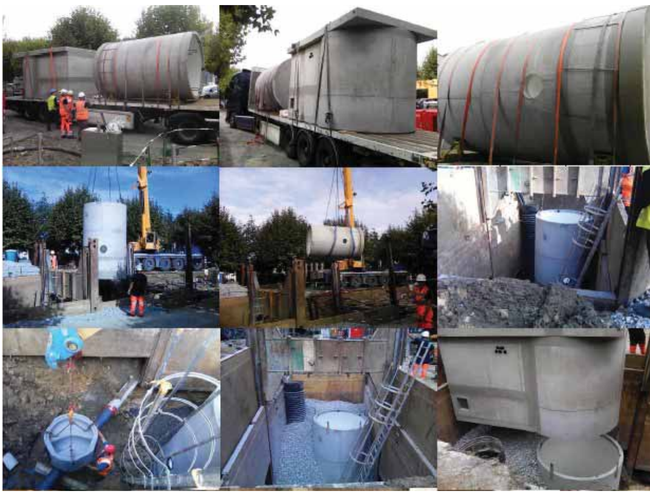
Renouvellement Poste Refoulement Secteur MAIF Niort
