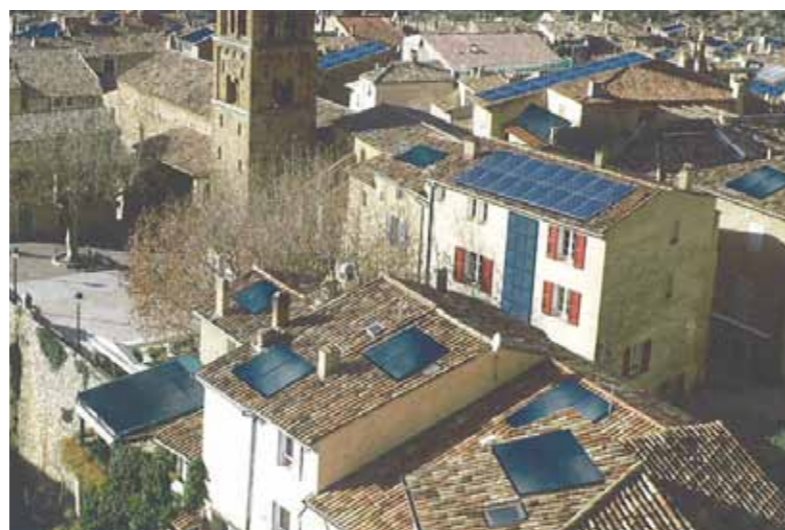
Solution tragique des panneaux solaires
