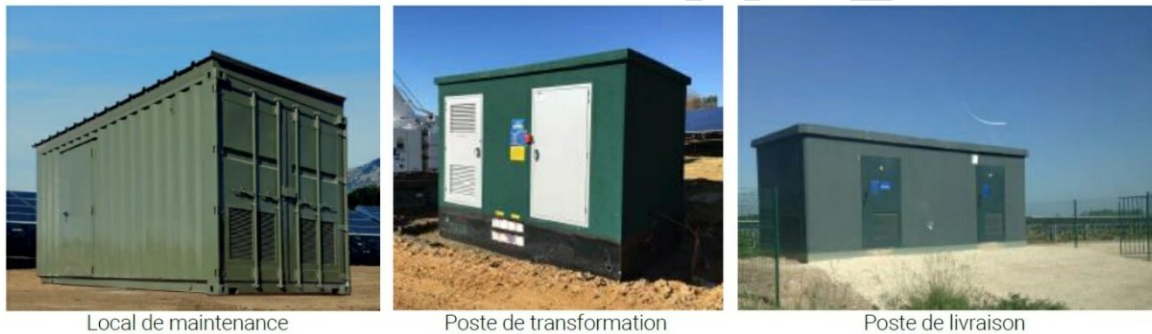
Locaux présents au sein de la centrale
