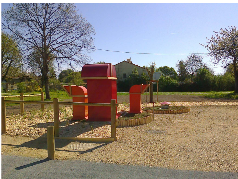
Figure 2 : poste Refoulement Amuré
